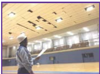
▲大山崎体育館の被害確認
